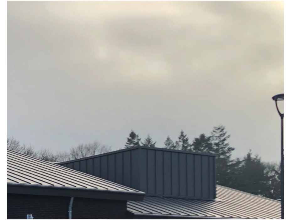
referentiebeeld installaties zijn geïntegreerd in de architectuur
