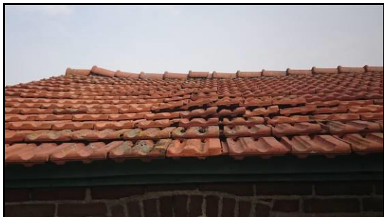
Afbeelding 10: Scheefliggende dakpannen en nokvorsten
