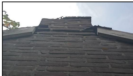
Afbeelding 3: Ruimtes onder loodflappen
